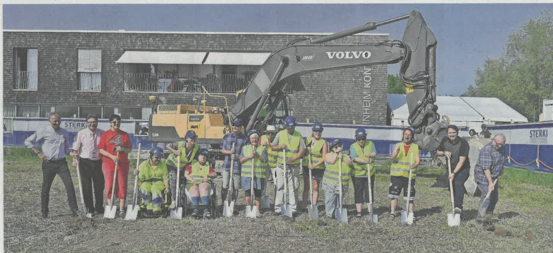
Spatenstich gemeinsam mit einigen Bewohnern des «Kontiki». Diese freuen sich riesig auf den Erweiterungsbau.
